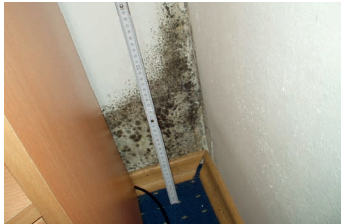
Schimmel in schlecht belüfteter Gebäudecke hinter Möbelstück
