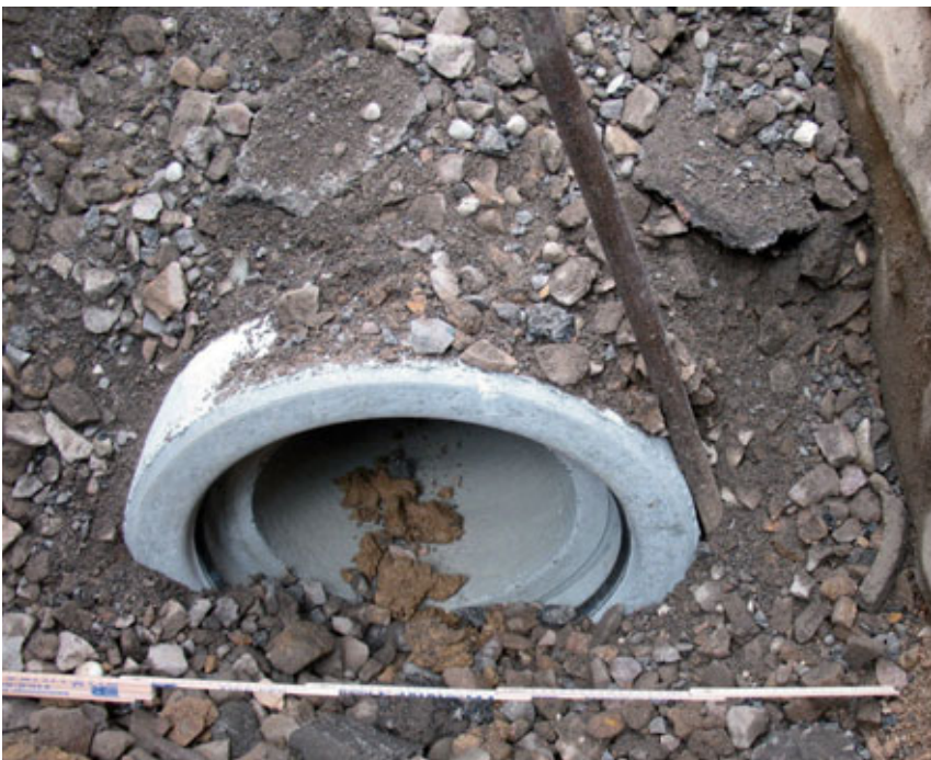
Abb. 5 Mangelhafte Leitungszone: Der Arbeitsraum zwischen Verbau und Rohr ist zu gering, um die fachgerechte Verdichtung der „Zwickel“ zu ermöglichen. Das Verfüllmaterial der Leitungszone ist steinhaltig mit Bestandteilen größer als 40 mm, zudem sind Fremdmaterialien enthalten wie etwa bituminöser Straßendeckenabbruch. Die Seitenverfüllung wurde nicht verdichtet.
