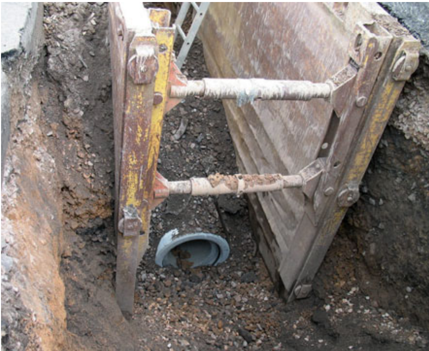
Abb. 4 Mangelhafter Rohrleitungsbau: Bei einem derart mangelhaften Verbau können die Seitenwände einbrechen. Der Rohrgraben ist nicht auf ausreichende Grabenlänge verbaut und der Graben nicht breit genug. In der Leitungszone befindet sich mangelhaftes Verfüllmaterial.
